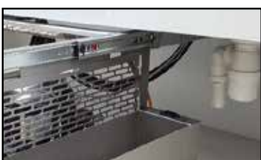
EVACUATION DES CONDENSATS
