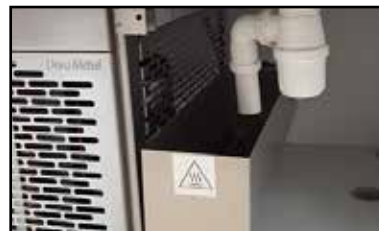
EVACUATION DES CONDENSATS
